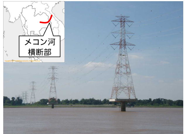
写真；メコン河を横断して両国国境を結ぶ送電線
